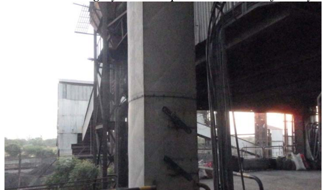
Photo 10: No SA header pressure gauge.
